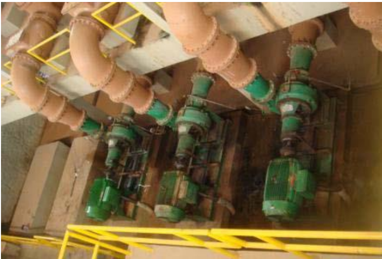
Figura 2. Conjuntos Motobombas da estação elevatória da ETE. Fonte: Plano Municipal de Saneamento Anápolis, GO.
