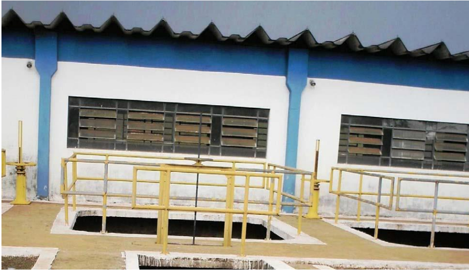
Figura 1. Poço de sucção da estação elevatória da ETE. Fonte: Plano Municipal de Saneamento Anápolis, GO.
