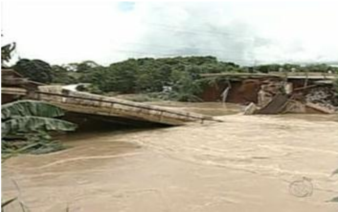
Imagem 18: Ponte caída após temporal em Itaberaí -GO
