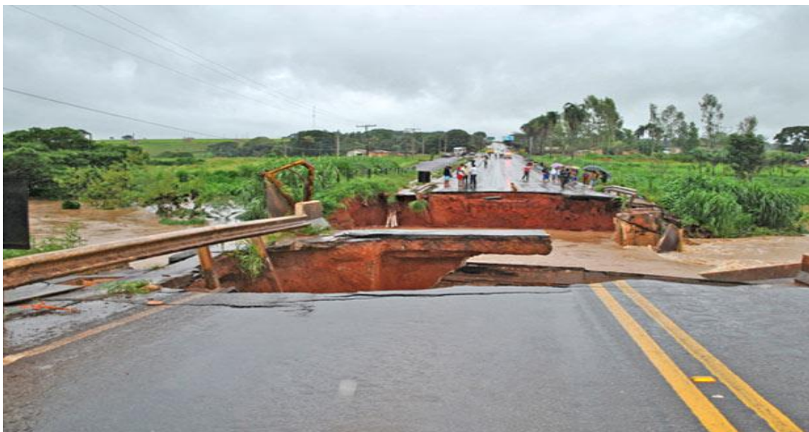
Imagem 19: Ponte caída após temporal em Itaberaí-GO
