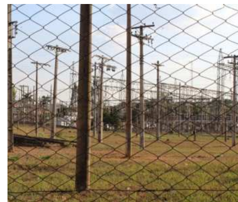
Figura 171: Estrutura vertical do sistema de energia elétrica na Subestação da CELG, um elemento bastante marcante na paisagem. Fonte: Acervo pessoal, 2016
