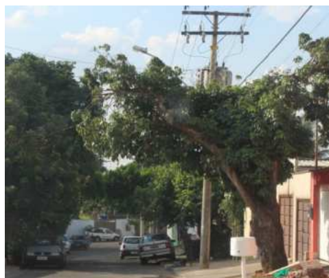
Figura 131: Conflito entre fiação pública e árvores, que são podadas de forma a se adequar a fiação. Fonte: Acervo pessoal, 2016.
