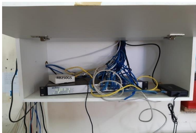
Figura 8-RB250GS e Equipamentos de rede
