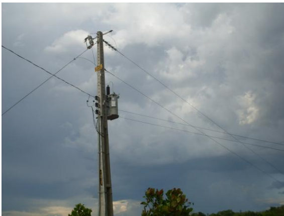
Presença de energia elétrica no assentamento.
