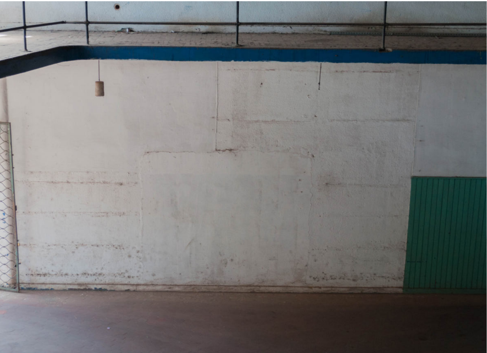
Figura 53: Parede que divide o estacionamento do centro de beleza . Fonte: Autoria própria.
