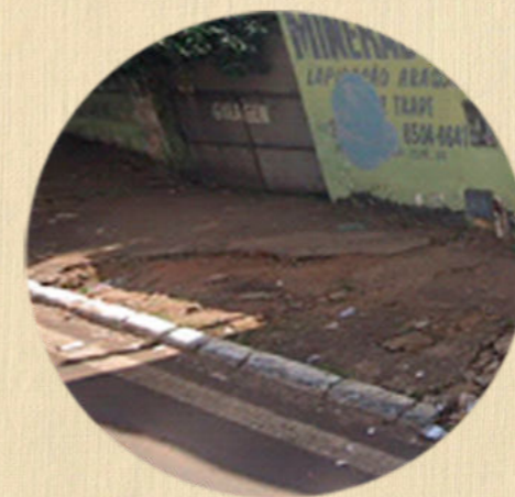
Figura 36: Passeio esburacado, sem manutenção, na Av. Goiás. Fonte: Google Maps, 2020.
